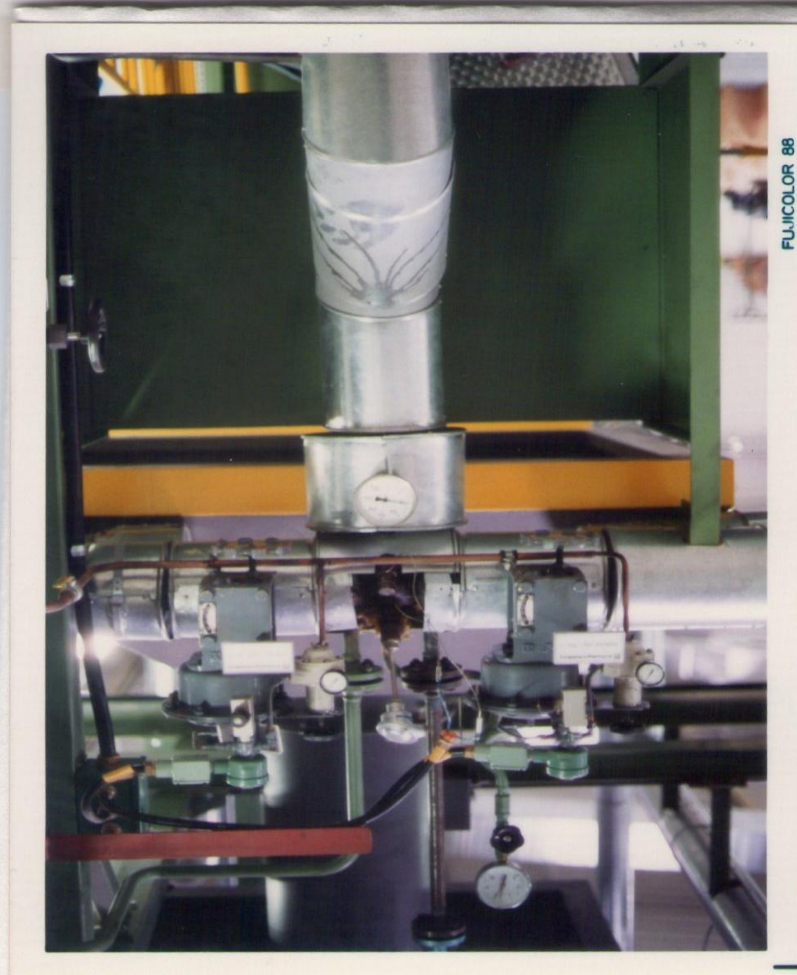
ボイラーとオイル加熱冷却装置
