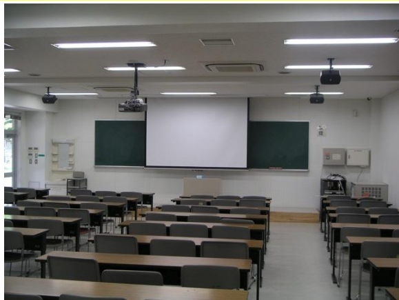
全講義室にAV機器、空調
